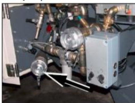
104 pav. Vandens rezervuaro užpildymas per išpylimo atvamzdį
